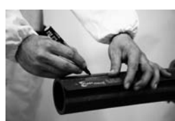
Fase 2 identificazione della zona di raschiatura
